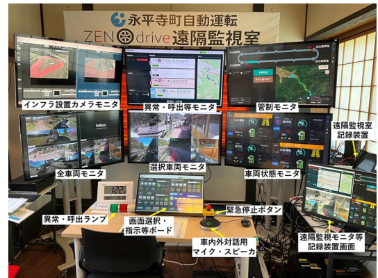
図1 永平寺町の遠隔監視室. 文献[2]より引用.
